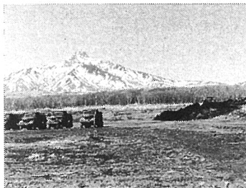
仙法志中学校 グランド造成工事 施工者 陸上自衛隊 名寄地区施設隊 完成 昭和53年 6月28日
