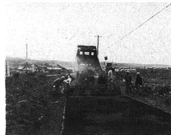
町道新湊栄浜線 舗装工事 施工者 三 井 道 路 (株) 北 海 道 支 社 完成 昭和53年 9月27日
