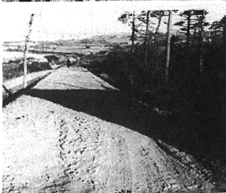
種富町畑線 道路新設工事 施工者 坂 本 建 設 (株) 完成 昭和53年11月30日
