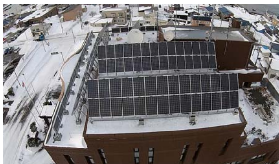
「役場庁舎屋上」太陽光発電設備
